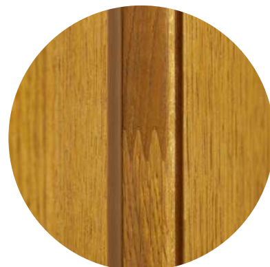
Różnice kolorystyczne łączeń**
